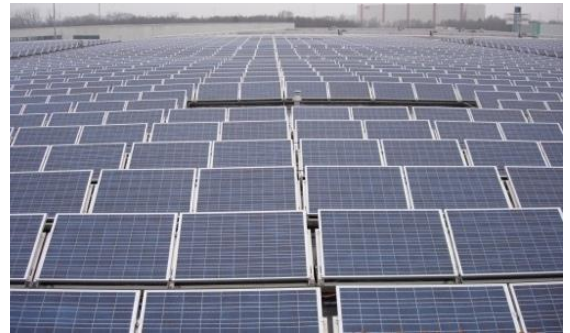
Zonnepanelen in een collectief
